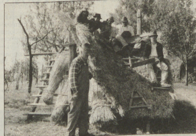
Vzorec strehe na zemlji, na katerem so se učili tečajniki, ki so na strehi. V ospredju mojster Lovrenc Lenc Kramberger.
