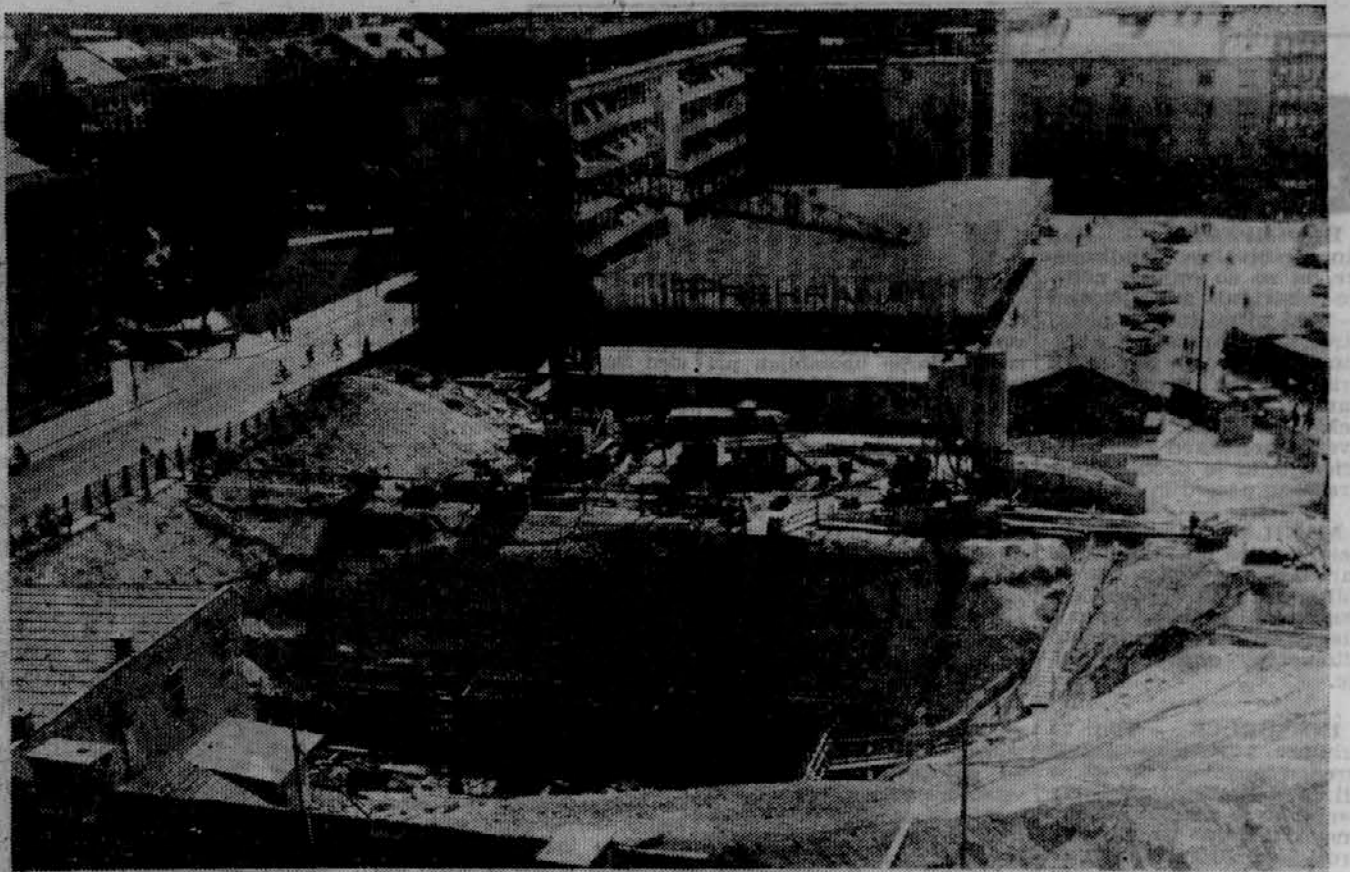
SPREMENJAJO SE LJUBLJANSKE RAZGLADNICE - Na gradbišču »Obnova« v Dalmatinski ulici so morali za temelje izkopati 12 metrov globoko jamo. Čez leta dni novega Doma sindikatov ne bo več moč slikati s te strani zakrivala ga bo nova 14-nadstropna stolpnica »Metalke«.
