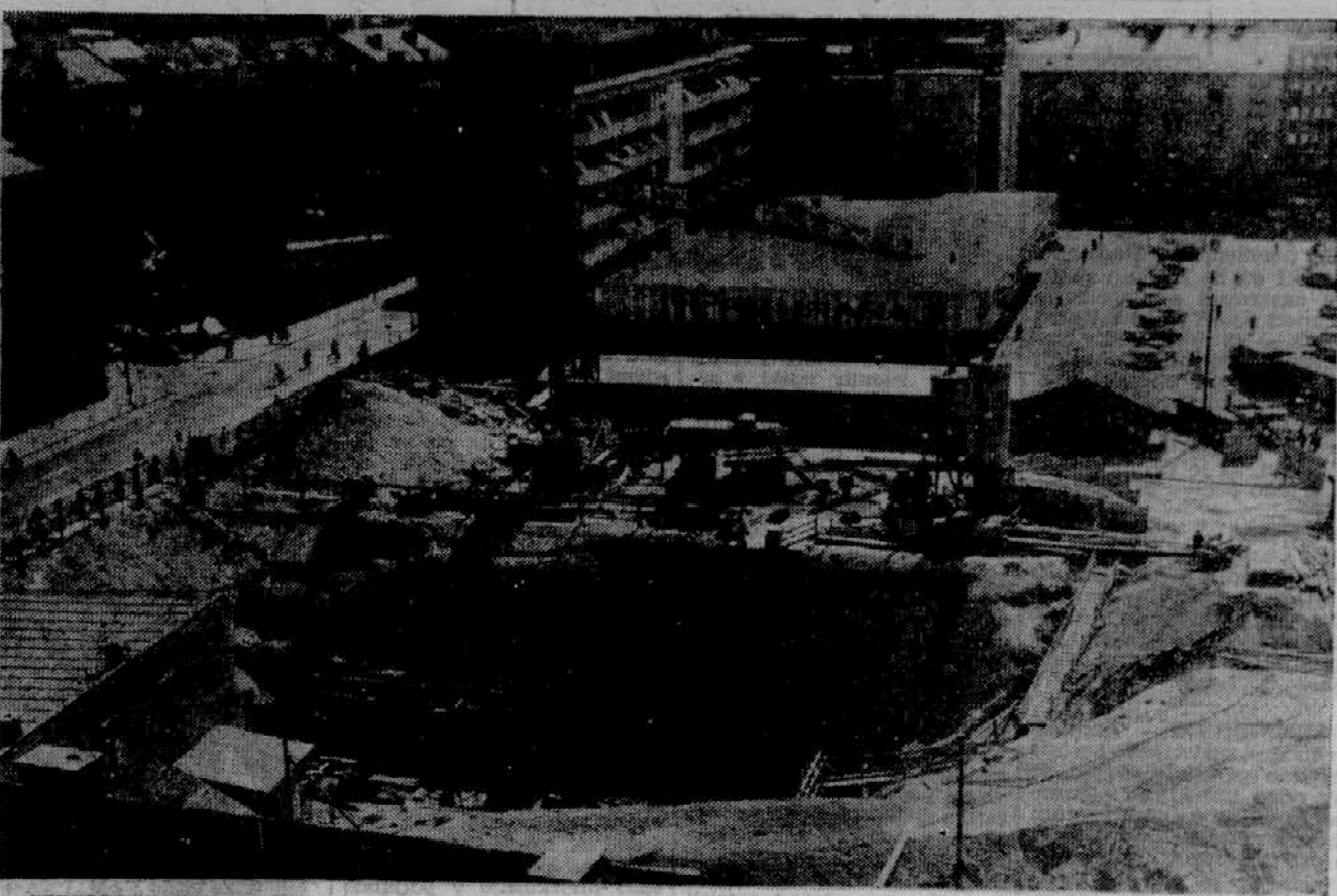
SPREMENJAJO SE LJUBLJANSKE RAZGLLEDNICE - Na gradbišču »Obnove« v Dalmatinovi ulici so morali za temelje izkopati 12 metrov globoko jamo. Čez leto dni novega Doma sindikatov ne bo več moč slikati s te strani, zakrivala ga bo nova 14-nadstropna stolpnica »Metalke«.
