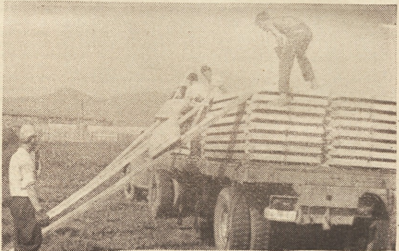
Nepravilno uskladiščene plošče
