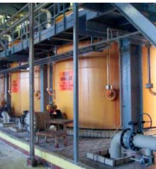
Pogled na linijo petih novih hidrolizerjev
