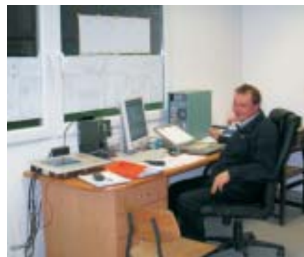
Preizkušanje centralnega nadzornega sistema
