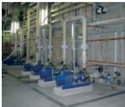
Rezervoarji in pretakišče dekarbonatizirane vode
