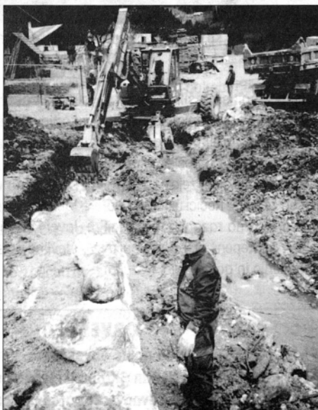
Podporni zid bodo zaenkrat financirali iz občinskega proračuna (foto: Savinjčan)
