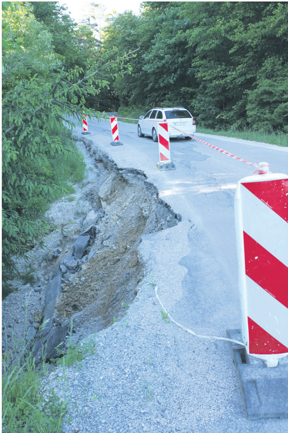
Letos spomladi je na državni cesti Velenje–Polzela po andraškem klancu v občini Polzela zdrsel del cestišča. Kot so sporočili z direkcije za ceste, bo izvajalec nevaren odsek začel obnavljati avgusta.
