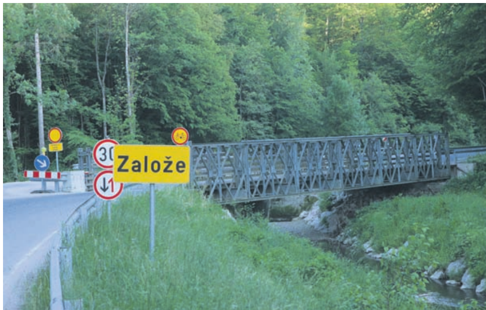
Most čez Hotunjščico že nekaj let ni prevozen. Poškodbo je povzročil vodotok, ki je spodjedel upornik mostu na desnem bregu potoka. Promet v vsem tem času poteka izmenično enosmerno čez nadomestni, jekleni most.
