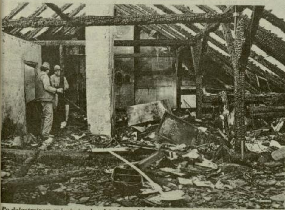
Po dolgotrajnem gašenju je od podstrešnega dela stavbe ostalo le še pogorišče.
