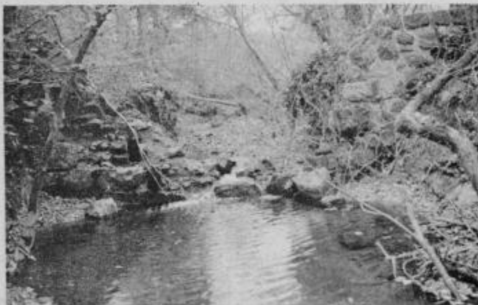
Voda je premagala betonsko pregrado.
