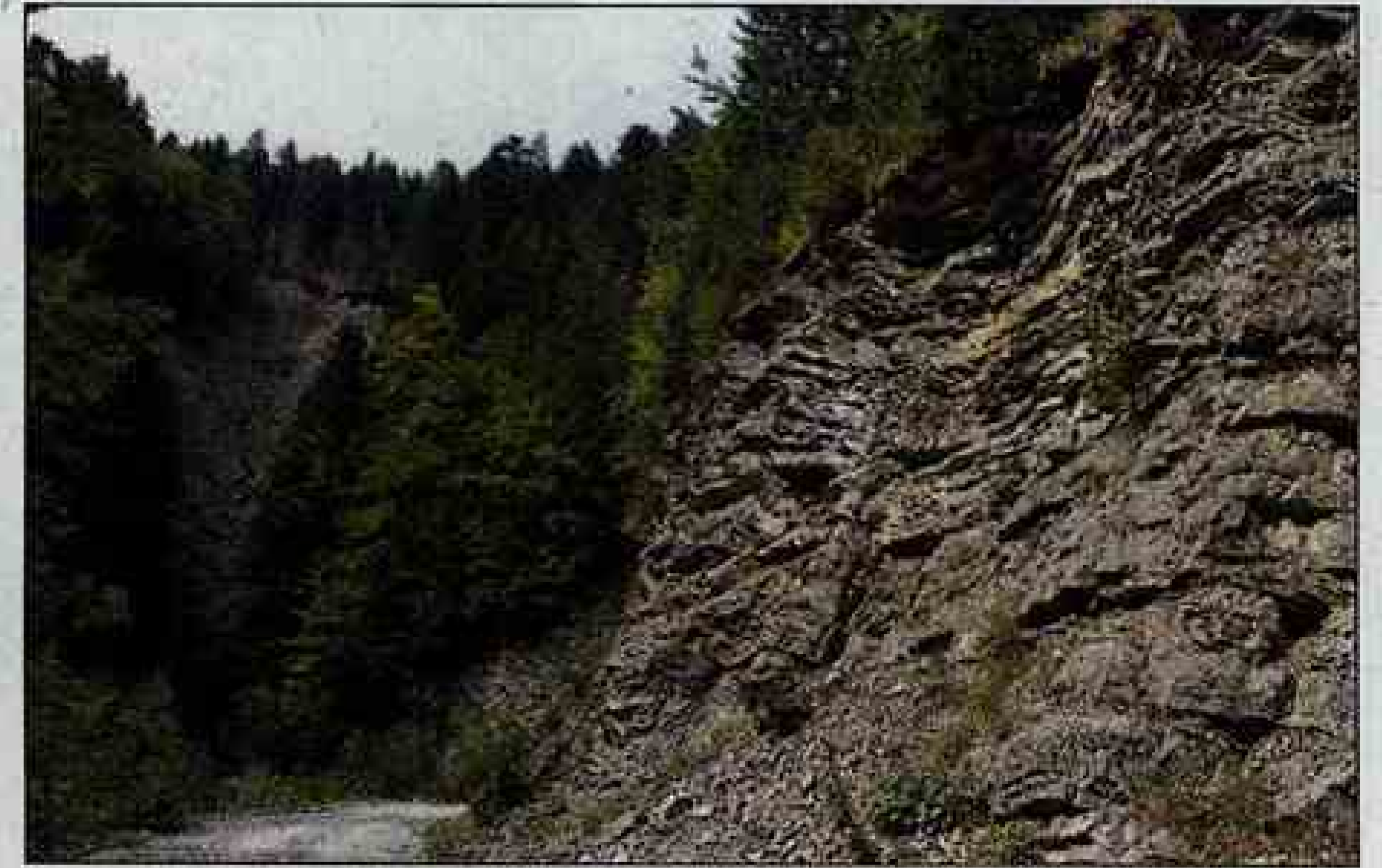
Zemeljski plaz in kamniti skladi ob poti
