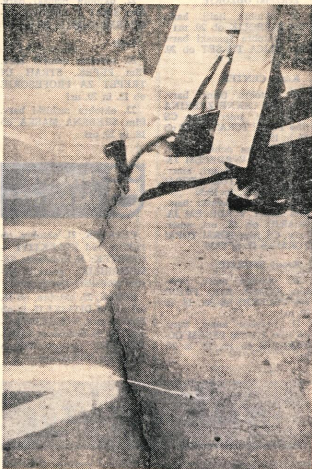
Na Kalvašiji pri Kranju je že dlje slabo zakrpan jarek. Lažja nesreča se je že zgodila. Počakajmo na kaj hujšega!? — Foto: F. Perdan
