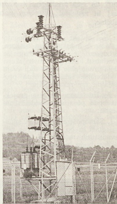
Nova transformatorska postaja v Begunjah
