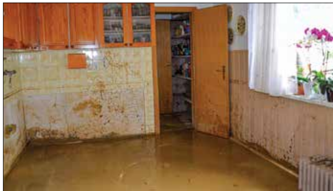
Pogled v pritličje ene od poplavljenih stanovanjskih hiš.
