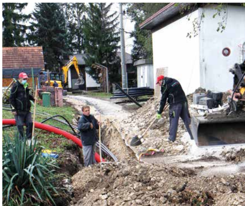
Z obnove vodovoda na Brinjski cesti v Ločici ob Savinji, kjer se bo oskrba s pitno vodo izboljšala za 11 gospodinjstev.
