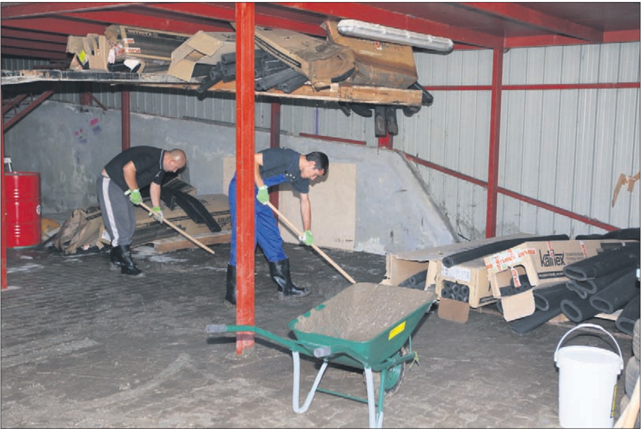
Takole so se vrgli na delo v poplavljenem skladišču podjetja Eho v Breznem.
