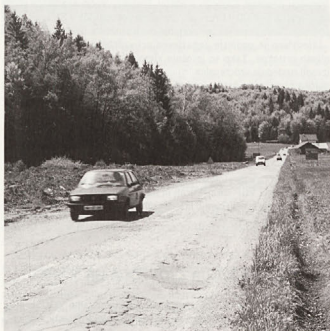
Del cestišča v Dolu - potrebna je temeljite obnove
