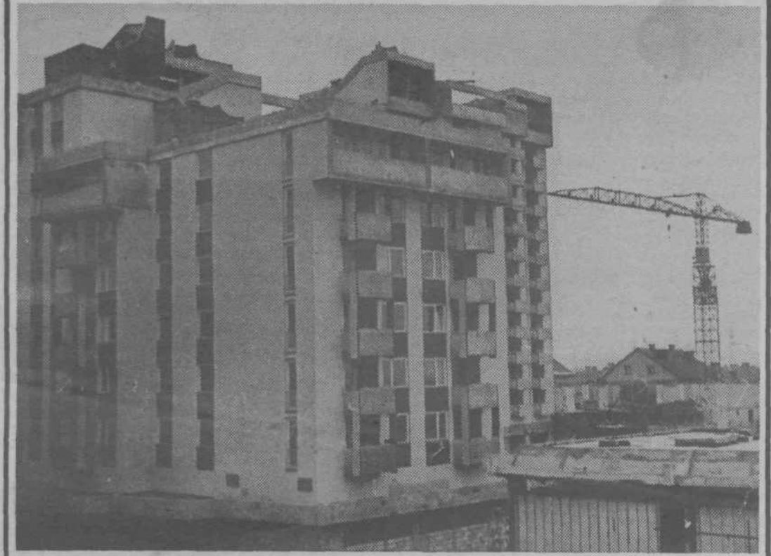
V središču Most gradbeno podjetje Pionir z vso vnemo gradi velik stanovanjski blok. V del tega bloka so se že vselili prvi stanovalci ostali pa se bodo predvidoma vselili do konca tega leta.
