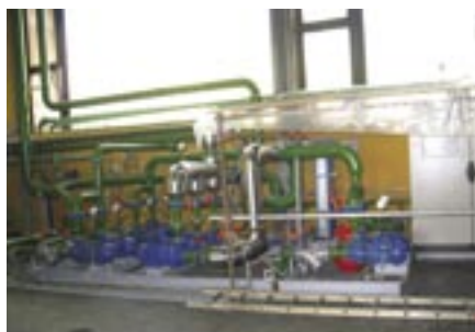
Notranji sistem hlajenja valjarne
