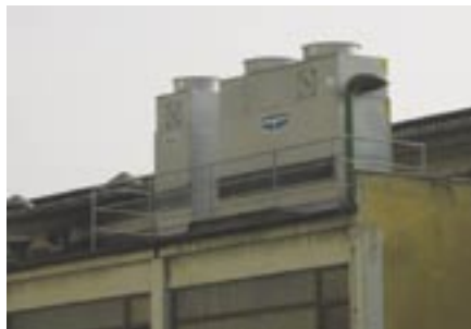
Hladilna stolpa za hlajenje valjarne
