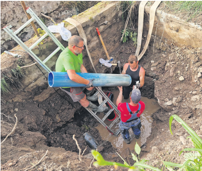
Delavci Komunale Radeče so ves minuli konec tedna popravljali v neurju poškodovan cevovod. Zaradi poškodbe je bilo približno 2.500 gospodinjstev več dni brez vode. (Foto: FB Tomaž Režun)
