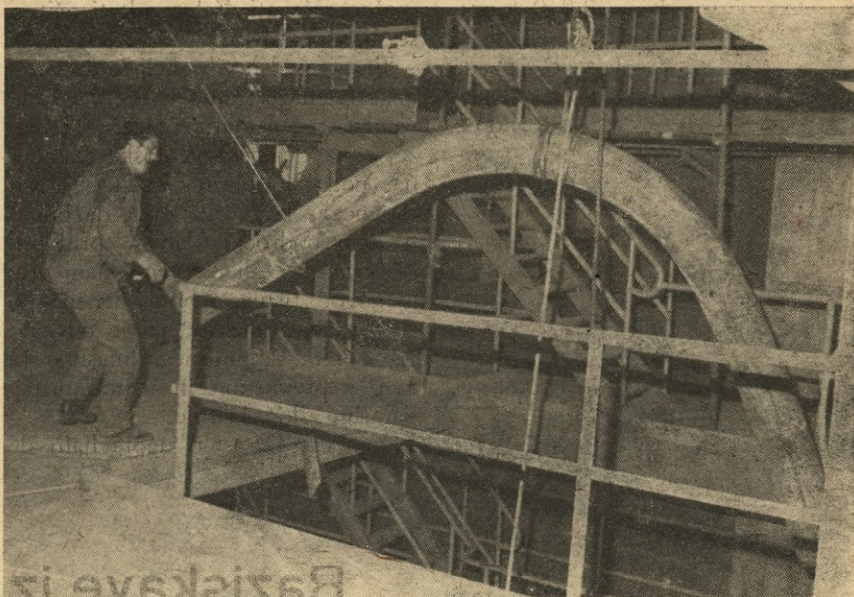
Termoelektrarna Trbovlje. V teku popravilo naprav po eksploziji.
