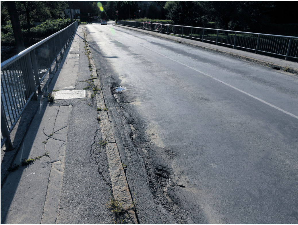
Prečkanje mostu na Polulah zbuja pri nekaterih občanih nelagodje, saj težja vozila povzročajo tresljaje. Da je most v slabem stanju, se vidi tudi na fotografiji. (Foto: Andraž Purg)
