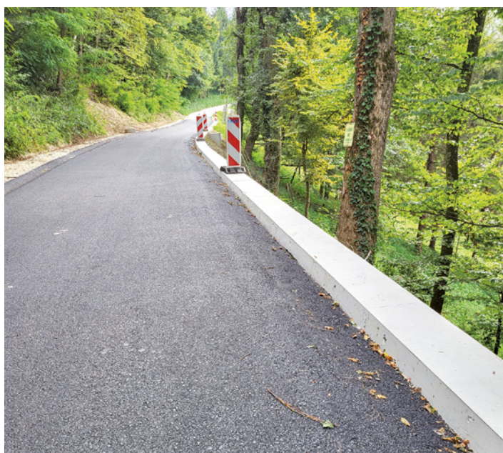
Obnovljeni cestni odsek v Gradiščih, kjer se je po neurju sprožil tudi zemeljski plaz.
