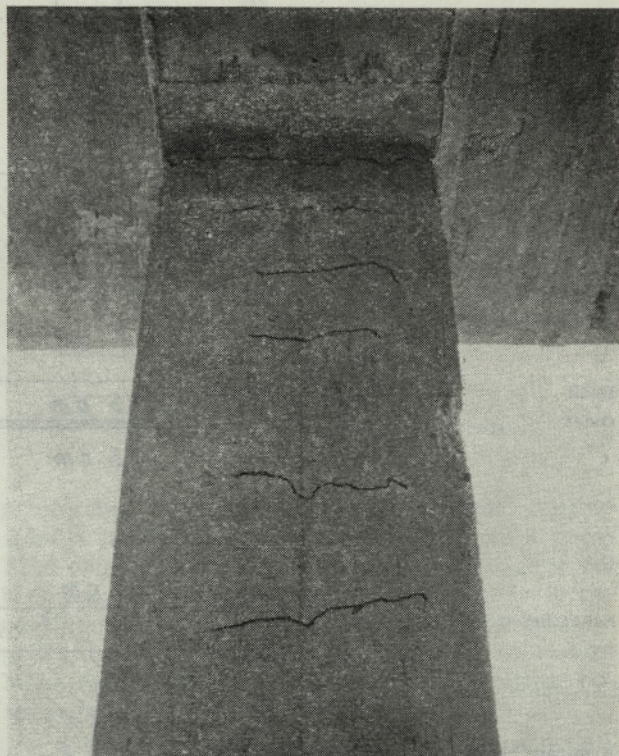
Sl. 13. Poškodbe na stebrov
