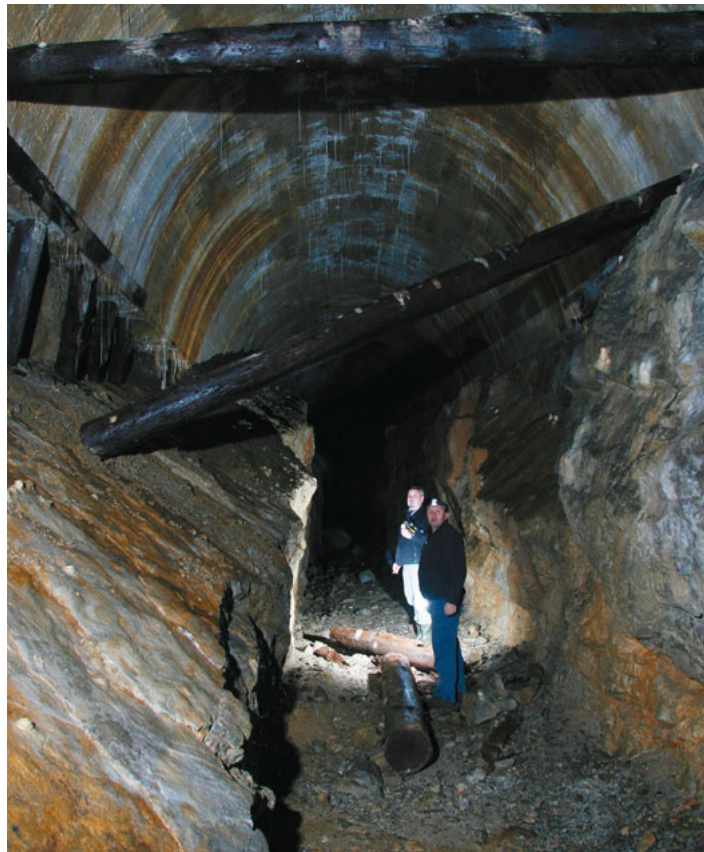
Kakih 250 metrov od južnega portala je zgornji obok predora že zgrajen (betoniran), spodnji del hribine pa še ne povsem odstranjen. Kot posledica del so se ohranile horizontalne podpore (stare skoraj sto let), ki jih na nekaterih mestih že prekriva сига. Na sliki sta avtor članka in dr. Andrej Mihevc z Inštituta za raziskovanje krasa ZRC Sazu iz Postojne. (Foto: Peter Gedei)
