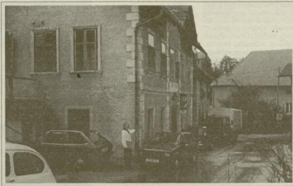
Zgradbo, v kateri je gostilna »Pri Micki«, v zadnjih petdesetih letih ni nihče obnavljal. Na čelni fasadi je več močnih razpok, napušč strehe je tako dotrajan, da se lahko vsak hip poruši na cesto, dotrajana so okna, dvomljiva je tudi požarna varnost. Strokovnjaki pravijo, da bivanje v hiši ni varno.
