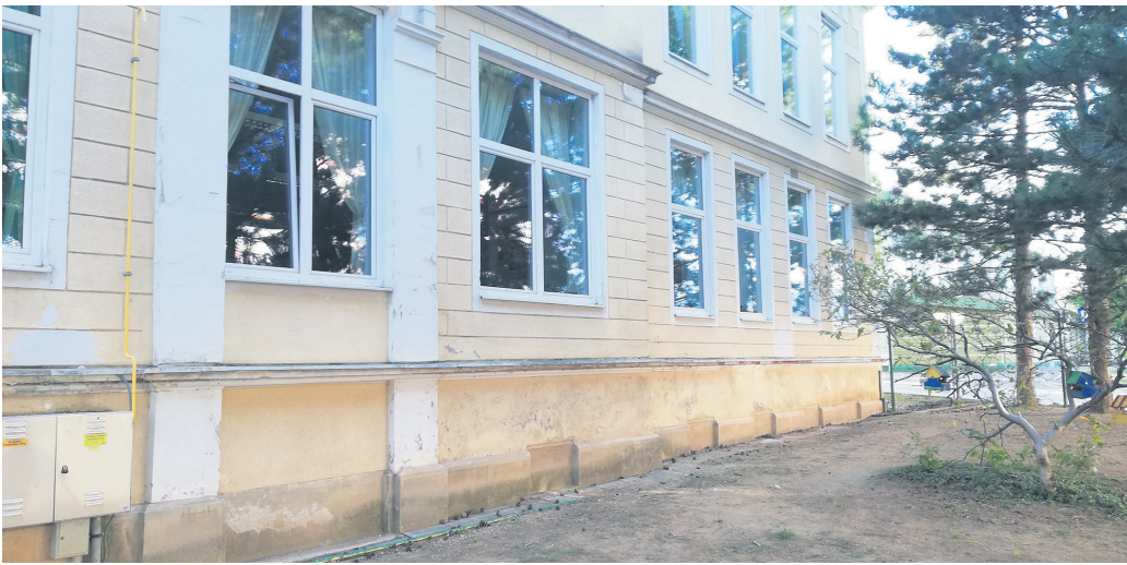
Najstarejša stavba OŠ Pod goro v Slovenskih Konjicah potrebuje prenovu.
