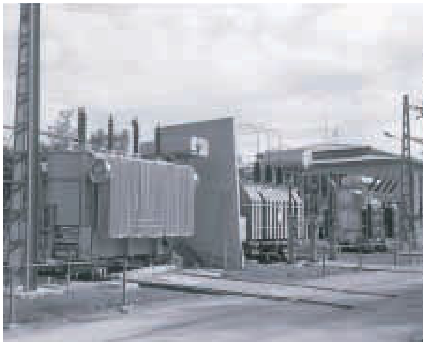
Trije energetske transformatorji v RTP 110 / 35 / 10 kV SELCE.
