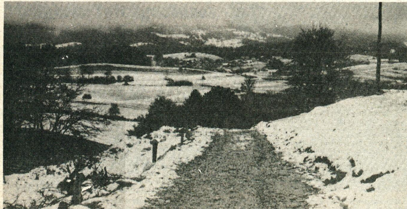
Cesto proti Česnjicam je kljub izredno težavnemu terenu in zimskim razmeram izdelal zasebnik Štefan Polajžar. Naročnik in domačini so z »izdelkom« izredno zadovoljni!
