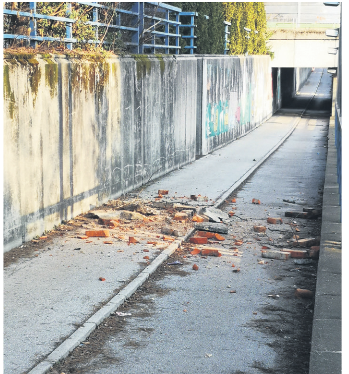
Opeka od potresa poškodovanega dimnika na kolesarski stezi in pločniku v Kersnikovi ulici
