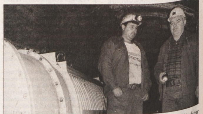
ZGODOVINSKA FOTOGRAFIJA - Džemal Kurtič in tehnični direktor Rudnika Kanižarica v zapiranju Tomislav Sekovanič ob transformatorju, ki je poganjal še zadnje črpalko za črpanje vode v rudniku. Fotografija je že zgodovinska, kajti tako transformator kot črpalko so sredi julija potegnili iz jame, 19. julija pa so začeli izvozni vpadnik zasipavati. (Foto: M. B.-J.)
