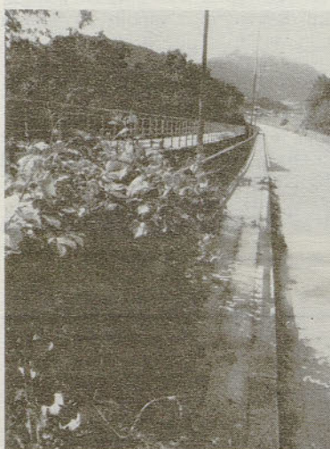
Divji hmelj na griškem mostu.
