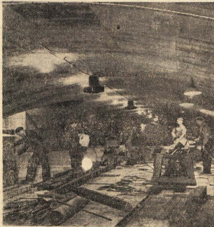
Na sliki vidite eno izmed zaklonišč, ki jih gradijo v Stockholmu. Zaklonišča imajo obliko predora. Po mnenju strokovnjakov jim ne bo mogla škodovati niti najmočnejša atomska bomba.
