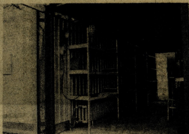
Pogled v notranjost skladišča vnetljivih snovi potrjuje večjo funkcionalnost ter skrbno izdelavo
