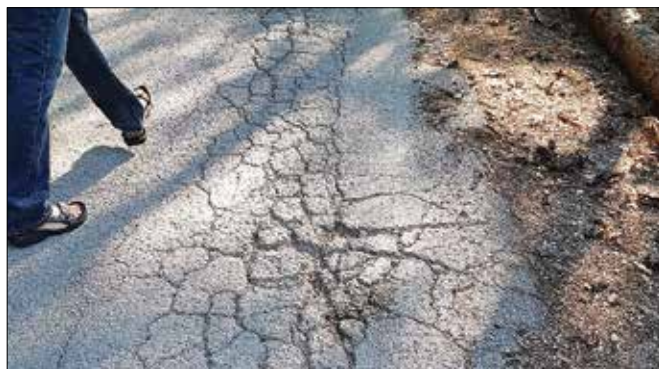
Cesta Križ-Florjan-Krnica je na več mestih zelo uničena.
