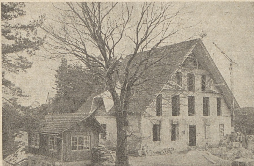
Poročali smo že v prejšnji številki našega glasila, da je v noči med 1. in 2. novembrom 1974, pogorel planinski dom na Zasavski gori. Na ruševinah so zagorski planinci pozidali v mesecu dni znova ta dom in 3. decembra 1974 dom že tudi pokrili. Dom ima tlorisno izmero 16,8 m x 12,1 m. Z deli bodo nadaljevali tako, da bodo dom odprli prihodnje leto.
