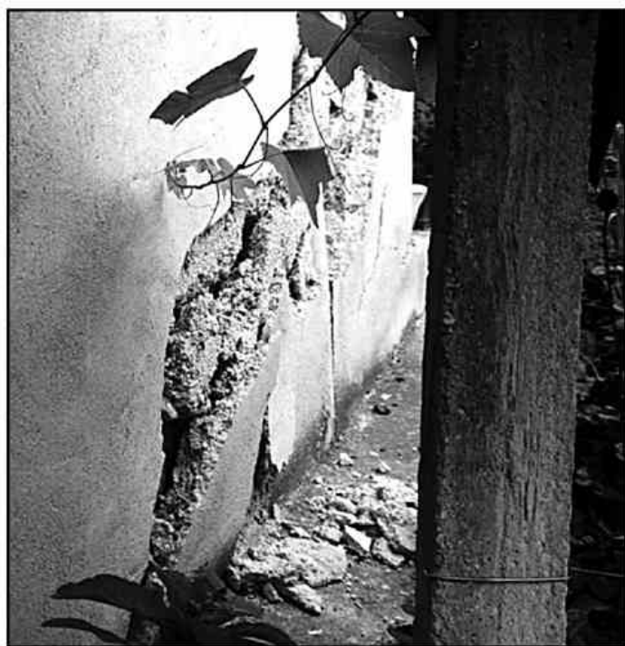
Najhujše razpoke so v kleti, pri temeljih. Videti je prav grozljivo. Sploh, ker Pavla pravi, da vsako noč sliši pokaanje in škripanje, da se hiša še seseda.
