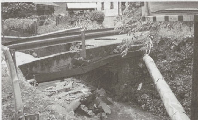
Ravnikarjev most se je pod težo vdal
