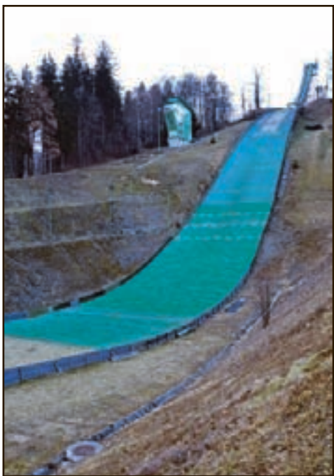
Gradbišče pod grajskim hrbtom je že pripravljeno. Če bo vreme dopuščalo, velike skakalnice in sodniškega stolpa do konca novembra ne bo več.
