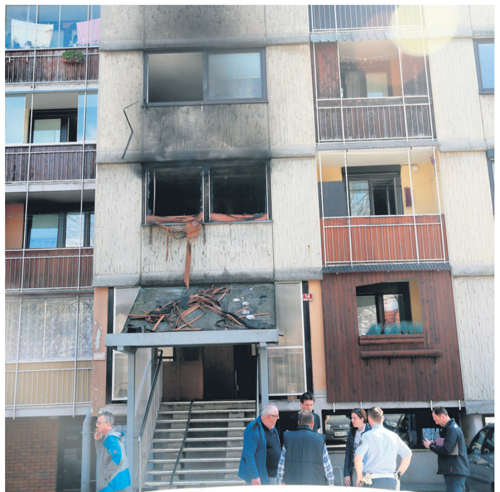
Ognjeni zublji in dim so poškodovali več stanovanj. Lastniki posledice odpravljajo še danes.
