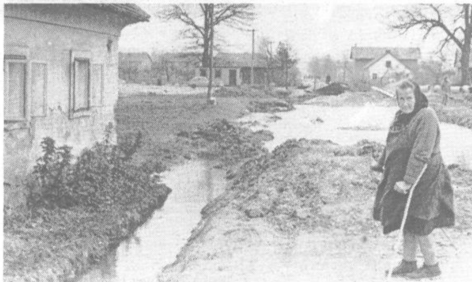
Ljudmila Škafar ne more razumeti delavcev kanalizacije, da brezbrizno puste gradbišče z vodo. Le skrbni intervenciji milice in gasilcev, predvsem pa lastni presoji, se ima zahvaliti, da ji hiše (levo) ni zalila voda
