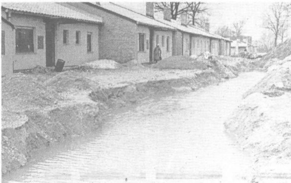
Voda pa je grozila tudi novim stanovanjskim hišam v Murglah. S posnetka je mogoče spoznati, da je gradbišče povsem odprto in nezavarovano
