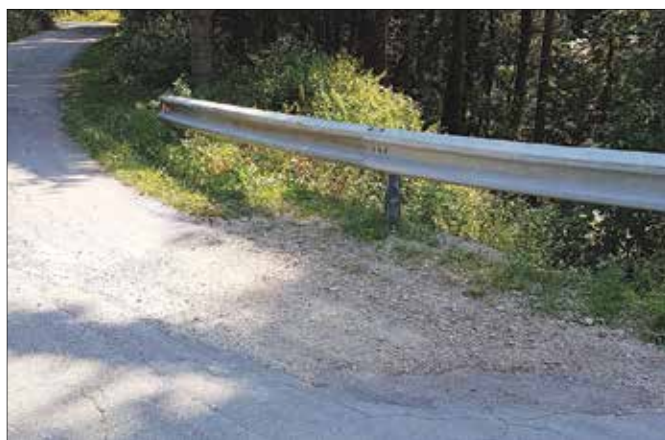
Cesta v Florjan je nujno potrebna rekonstrukcije. (Foto: Jožica Rihter)
