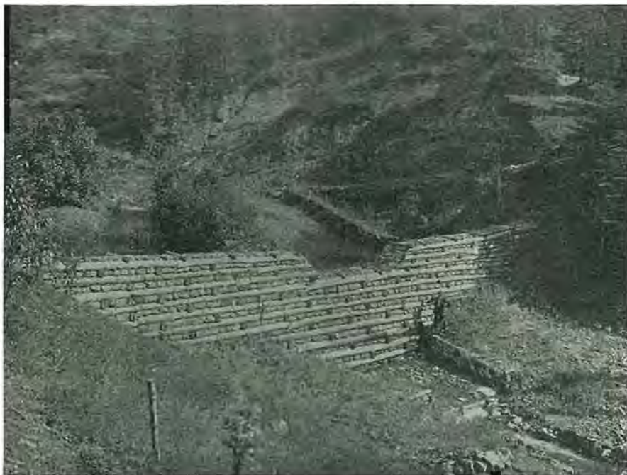
Pregradbe iz lesa in kamna v Meljcovi grapi pri Zireh radi zavarovanja rušljivih bregov in plazljivega pobočja ter ustavljanja materiala (foto: hudourniški odsek banske uprave v Ljubljani)
