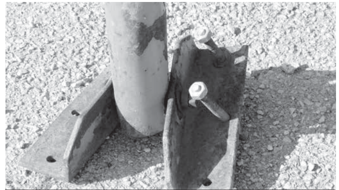
Poškodovana ovira na mostu čez Pšato pri OŠ
