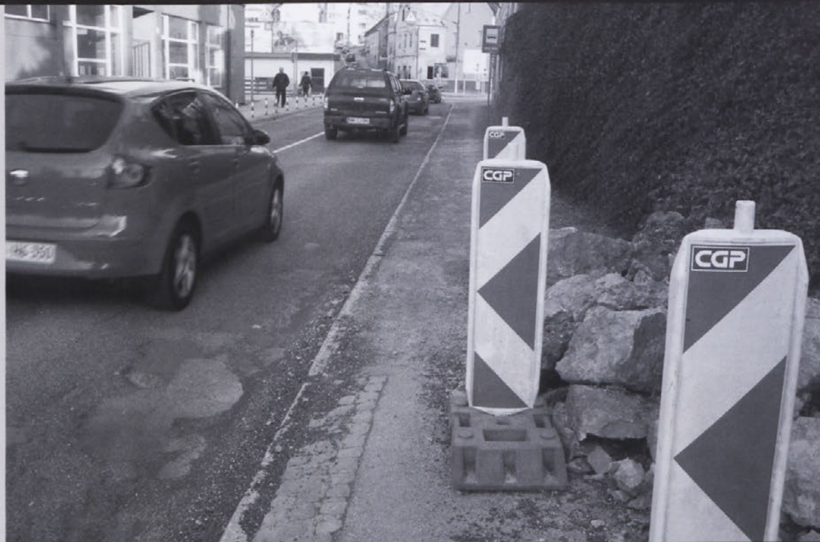
Udrta, preluknjana in uničena asfaltna površina, škarpa, ki se ruši neposredno na pločnik in na cesto, v ozadju neurejeno avtobusno postajališče na Kandijski cesti.
