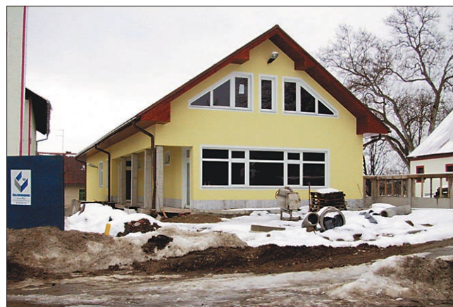
Zdravstveni dom v Vidmu čakajo še ureditev okolice in notranja gradbena dela
