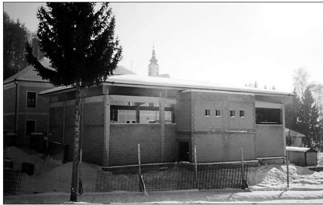
Telovadnica je pod streho, strupen mraz pa je z gradbišča pregnal delavce
