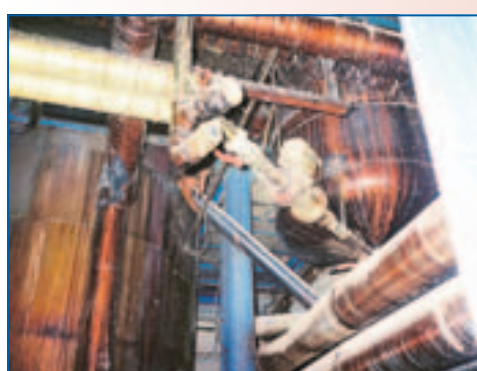
Usodni ventil pod kotlom fenol destilata
