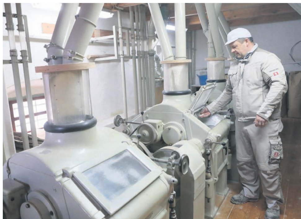
Mlin so celovito prenovili v začetku 90. let. Takrat so posebno pozornost namenili posodobitvi notranjosti, od stavbnega pohištva do mlinov. Staro obrtniško znanje so nadgradili z najnovejšo tehnologijo. Stroji za sejanje moke so novi in visoko zmogljivi.
