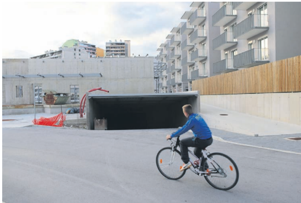
Gradnja poslovno-stanovanjskega objekta Gorica v Velenju se po zapletih vendarle bliža koncu.
