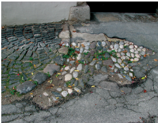
Originalni loški tlak, pred leti še ohranjen ostanek kombinacije granitnih kock in prodnikov. (foto: Mateja Kavčič)
