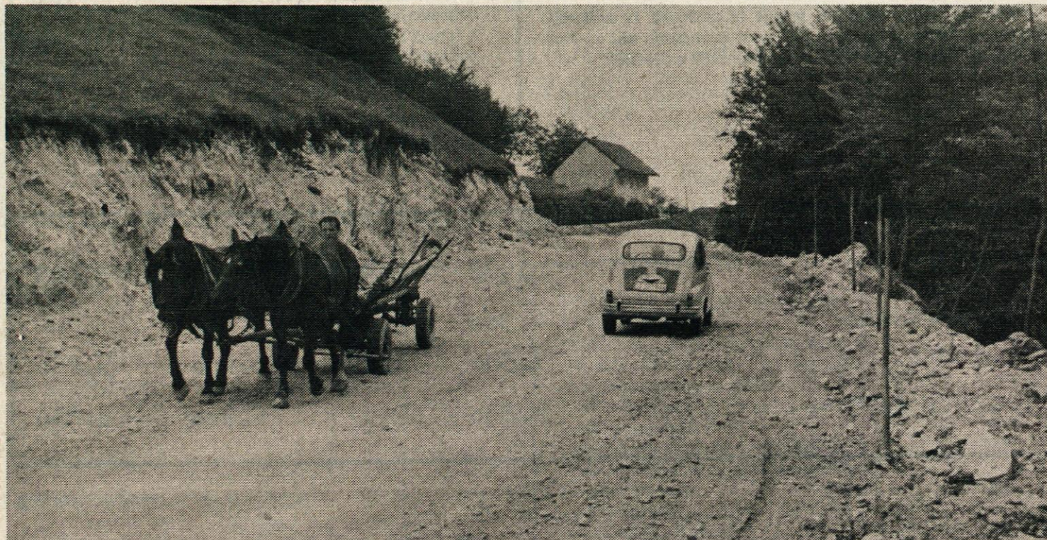
Vzdrževanje in tudi novogradnja cest bo v prihodnjem srednjeročnem obdobju zavzemala najpomembnejše mesto.
