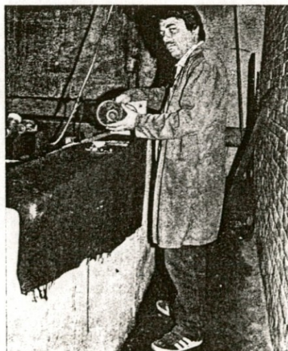
Skrb za naravo zahteva redno popravilo inštrumentov za čistilno napravo
