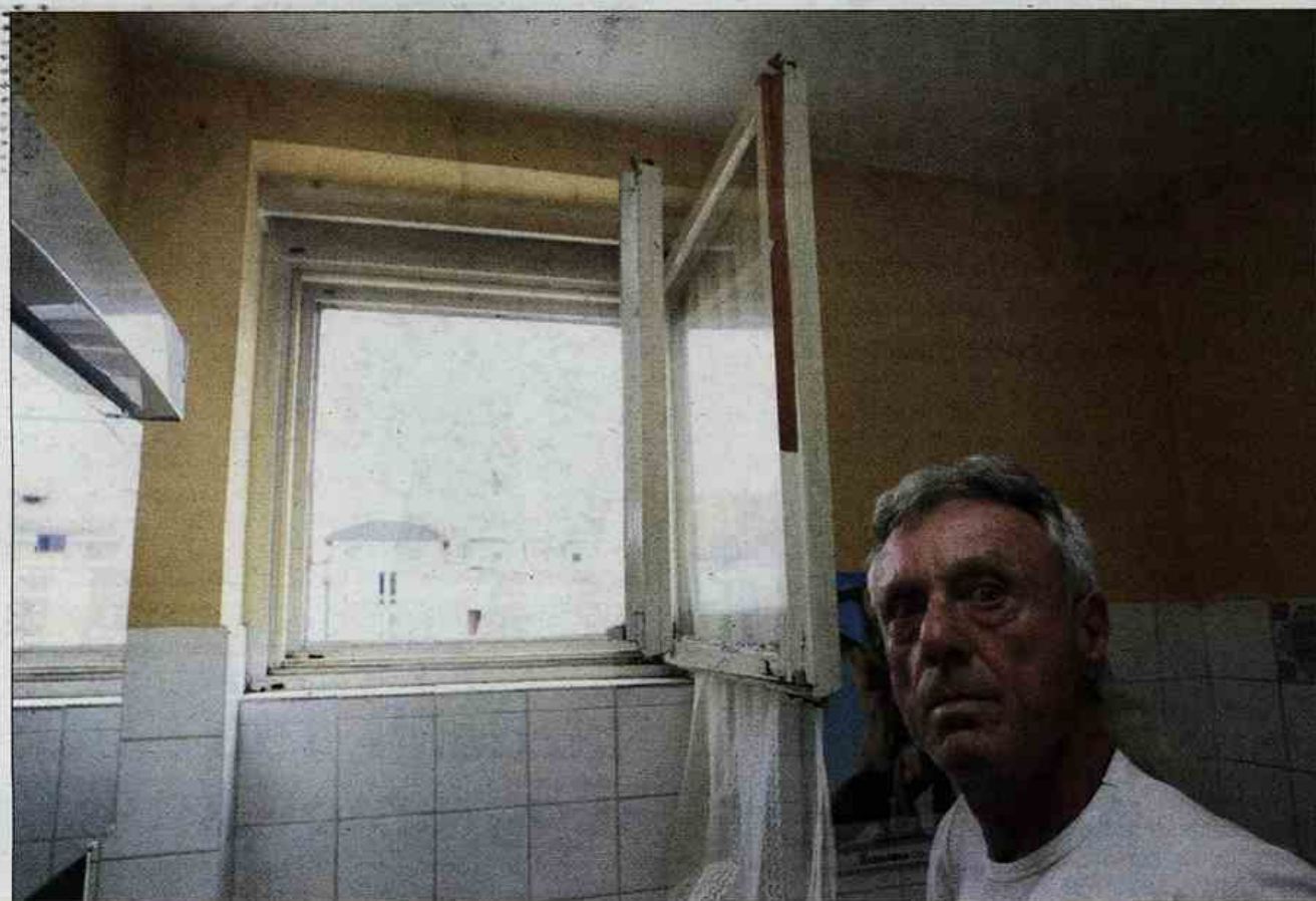
Roman Žlender pri oknu, ki je potrebno zamenjati.
